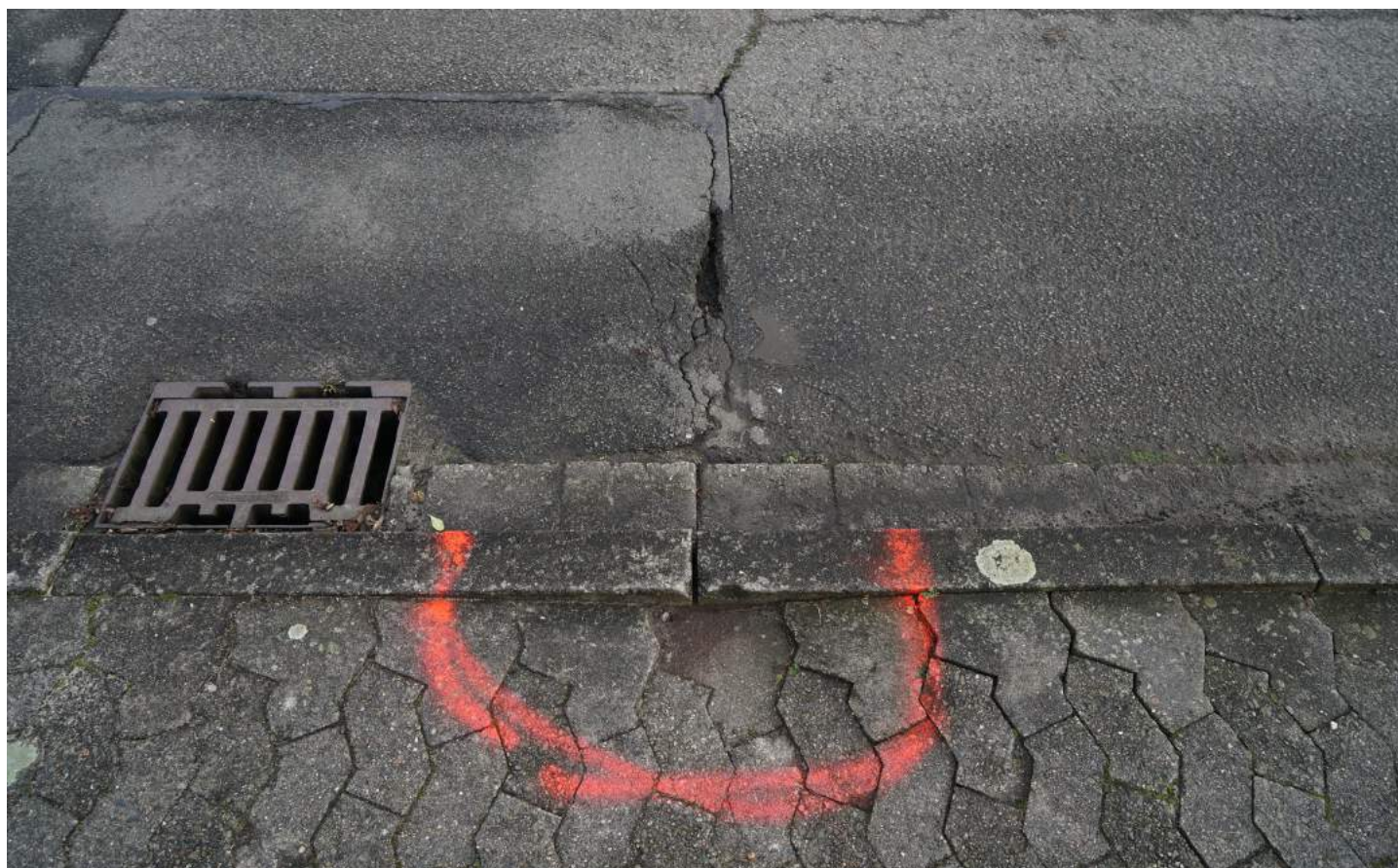
Einer von vielen Gehwegschäden in Hohnstorf, hier beispielhaft in der Straße "Neues Land".
